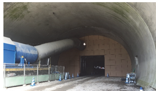
写真 11 特殊風門の設置完了状況
