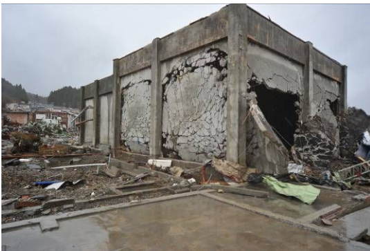
図6 女川町のRC造建物，壁の破壊 .
