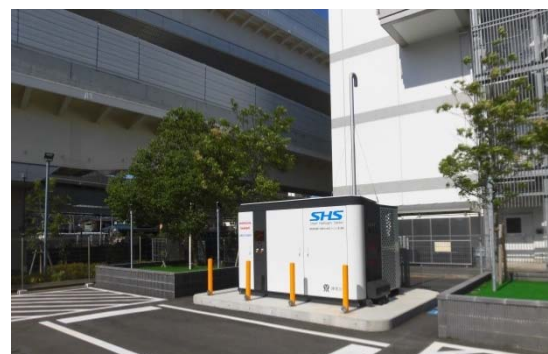
写真6 スマート水素ステーション
