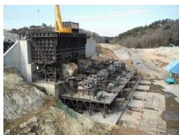
写真-2 破碎設備
