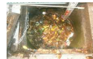
しゅんせつ実施前 泥土が堆積し、排水機能が失われています。
