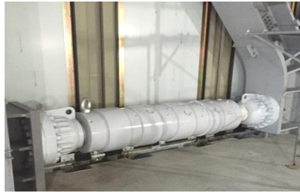
写真1 高減衰オイルダンパー (工事中の建物における取付状況)
